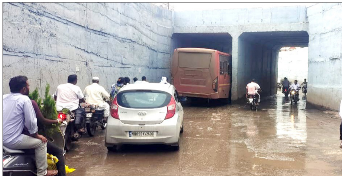
सांगोला : सांगोला मिरज रोडवरील रेल्वे भुयारी मार्गाखाली पाण्याची गळती आणि खडे पडल्याने नागरिकांना तारेवरची कसरत करावी लागत आहे.
